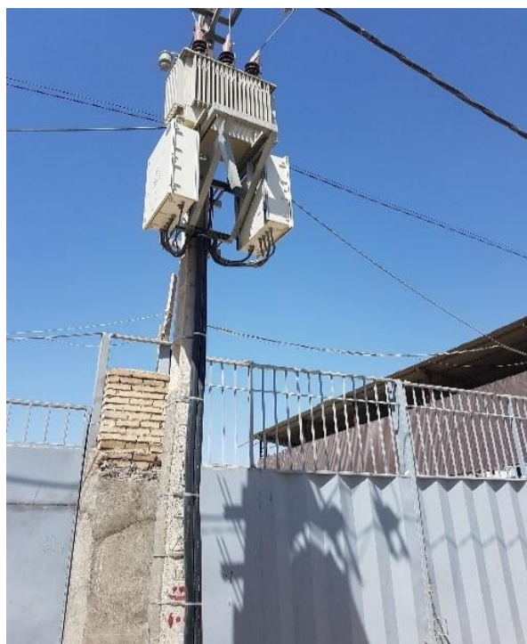
شکل ۳- پست هوایی یکپارچه نصب شده
